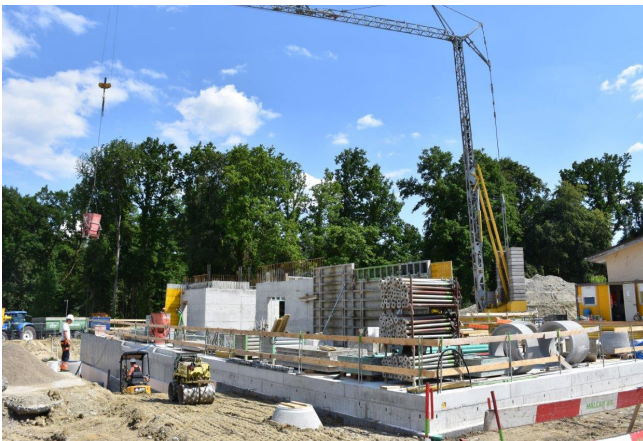
Construction du nouveau bâtiment de bureaux de SUISAG, avancement des travaux au 27.05.20
